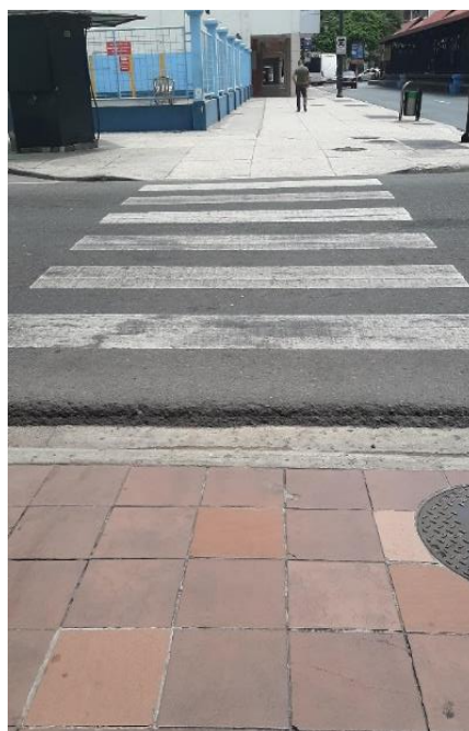
Figura 4. Desnivel para acceso al cruce peatonal. Fotografía: César Santana.
