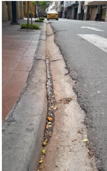
Figura 5. Desnivel en la calle Boyacá. Fotografía: César Santana.
